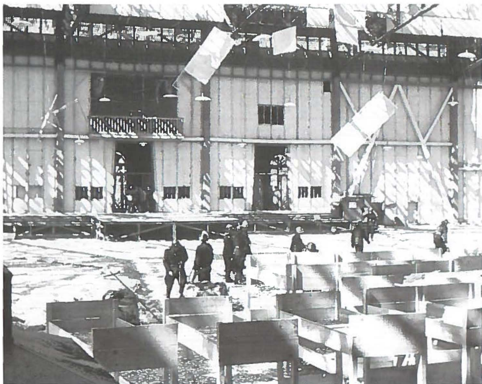
Sprengningen af Forum den 24. august 1943 blev besættelsestidens mest berømte sabotage. På billedet ses de mange etagesenge, der skulle have været benyttet til den kommende soldaterindkvartering.
