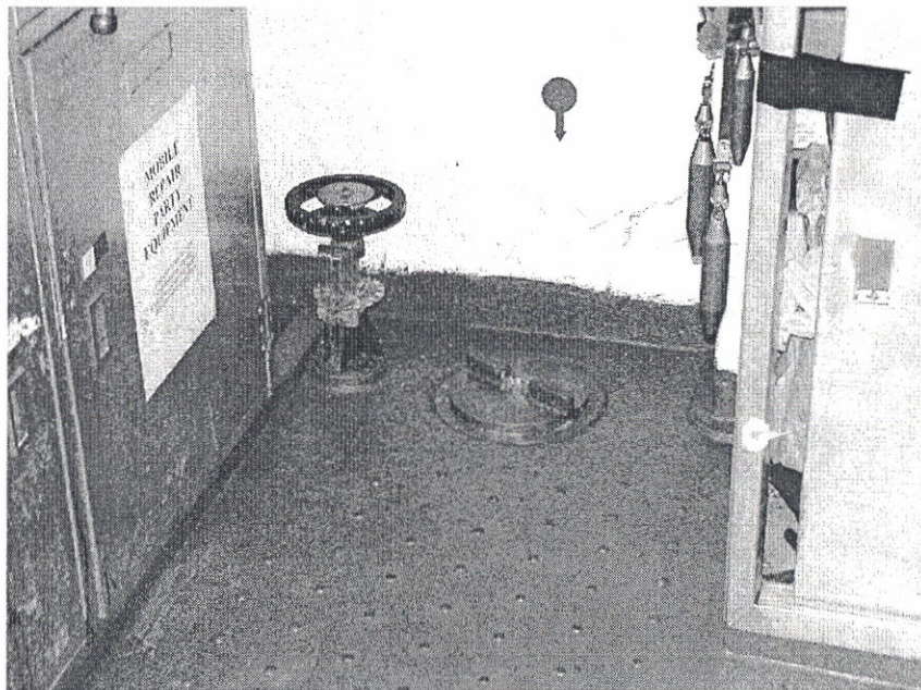
Billede 2: Dræn fra højtliggende rum.
