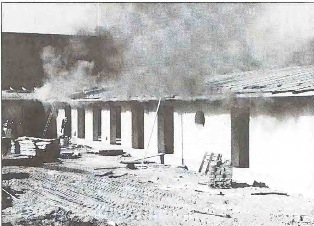
Den kraftige røgudvikling gjorde, at røgen kom ud under tagskæget hele vejen rundt om tilbygningen. (foto s-n)
