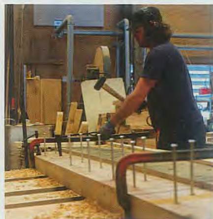
Skibstømrer Jens Møller Martensen i færd med at montere egetræsklædningen på de svære spanter.
