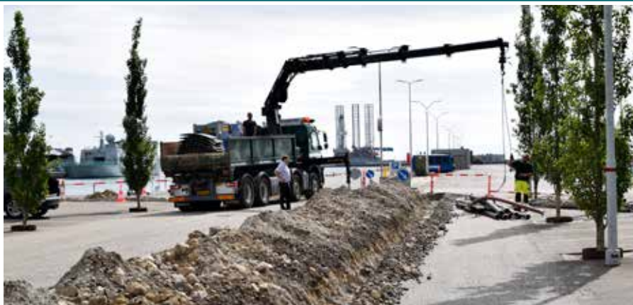
▲ En række bygge- og reparationsprojekter pågår hen over 2019 på Flådestationen i Frederikshavn.
