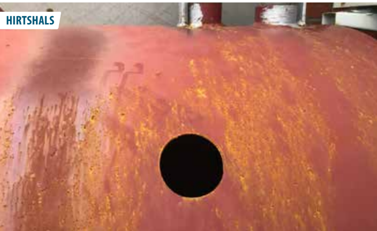
▲ Professionelt arbejde udført ved tømning af olietanken ved marnehuset på Hirtshals Havn. (Foto: Poul Erik Frandsen)
