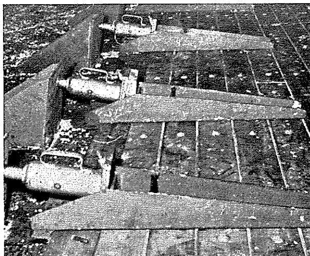
Planker med gummilister imellem presses sammen og ned mod dækket på samme tid.
